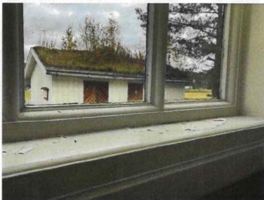
Skader innvendig karm.
