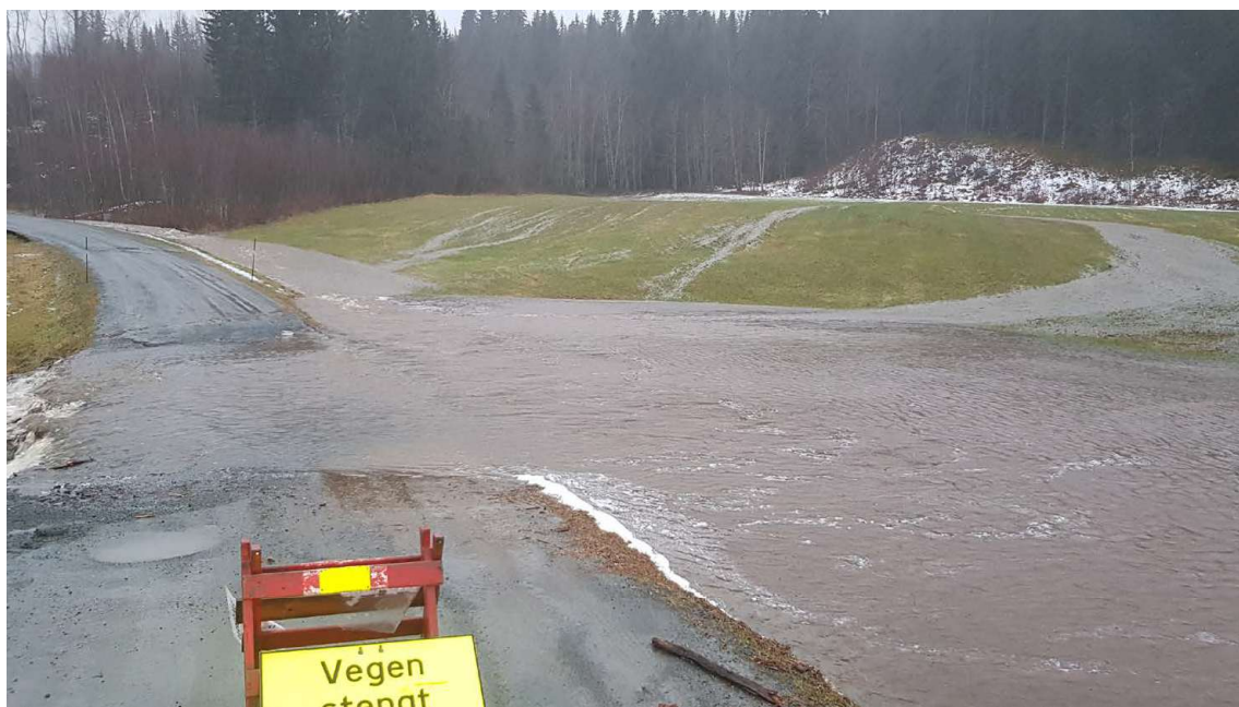
Figur 14: Flom ved Jonsveien 13.01,2022, etter ekstremnedbør. Underdimensjonerte stikkrenner, både ved flompunktet og lenger opp i vassdraget, er nå skiftet ut.
