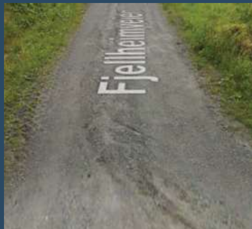
Eksempel på tilstand 2 fra Fjellheimveien (Google streetview).
