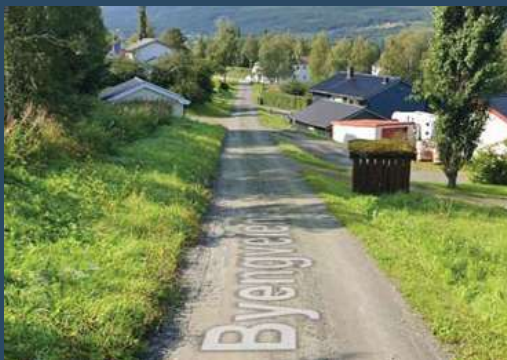
Eksempel på tilstand 1 er Byengveien (Google streetview). Tilstand vurderes ut fra tid på året der veien er på sitt dårligste, dette bildet er tatt når det er tørt og fint.
