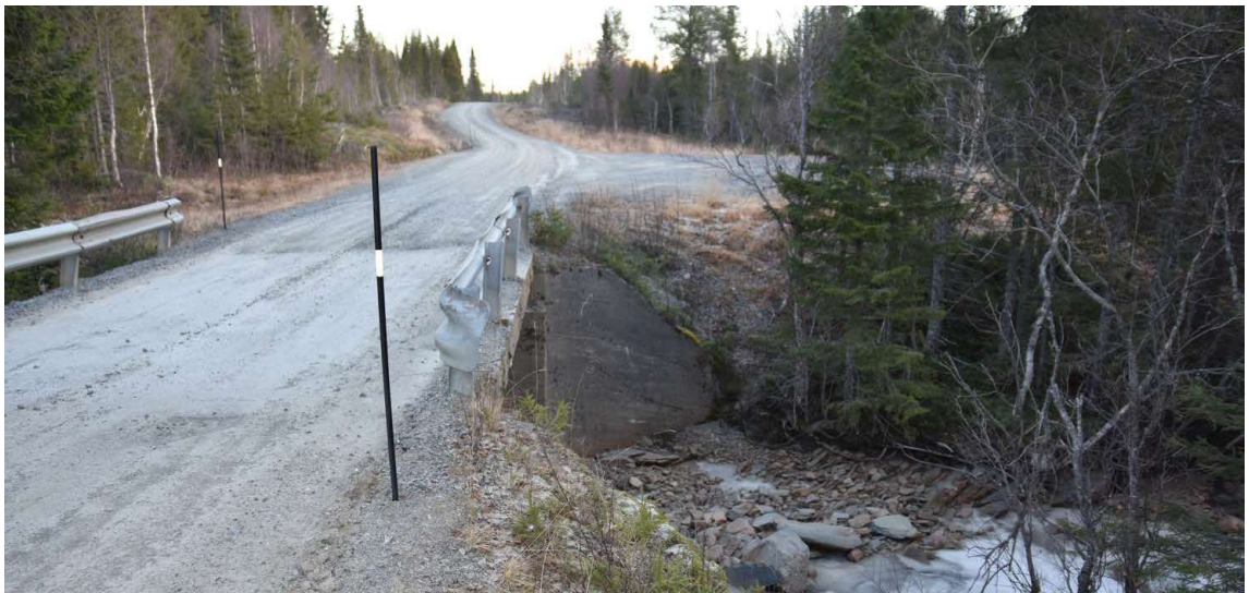
Figurer 6 og 7: Begge bildene er fra Torsbjørkveien. Eksemplet over viser betongrekkverk fra Solbakken (Mansæterbakken 2) som ikke holder godkjent standard/høyde. Eksemplet nederst viser rekkverk på bru over Mannlibekken som ikke dekker nok farefullt område.
