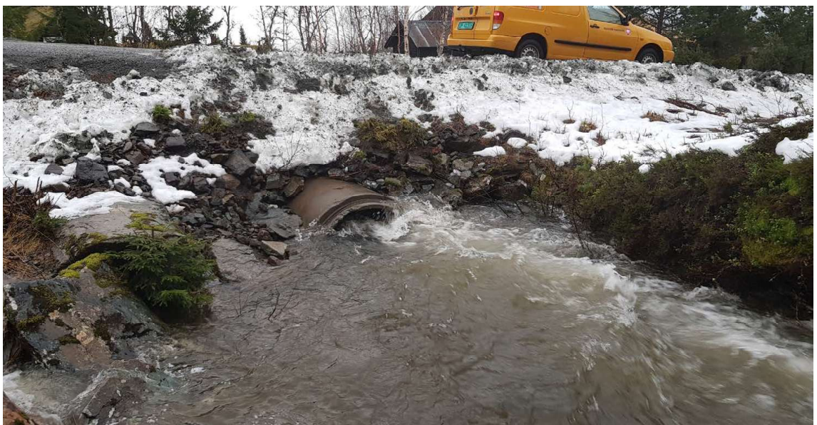
Figur 12: Bildet viser rør ved bekk i Fagerliveien med dimensjon Ø 1200 mm som knapt klarer å ta unna vannmassene.
